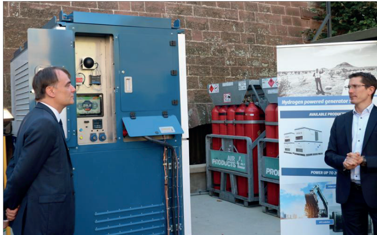
Le générateur à hydrogène Thytan a été installé à la préfecture de Belfort, en présence du préfet, Raphaël Sodini (à gauche), et de Sébastien Faivre, président de H2SYS. Photo DR
