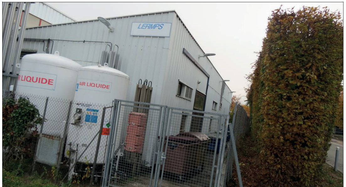
■ Au milieu du bâtiment, on apercevait, hier, la trace noirâtre qu'a provoquée l'explosion.
