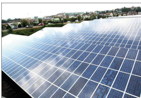
■ Le parking photovoltaïque de PSA à Sochaux, exemple d'innovation. Photo. Lionel VADAM
